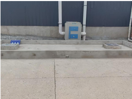
项目废气处理设备
