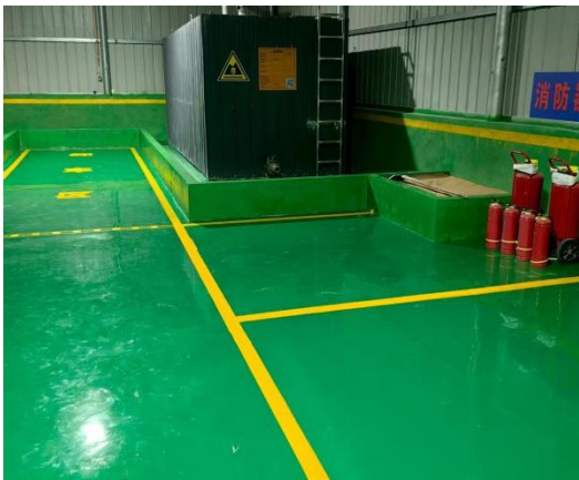
贮存库危废标识标牌
